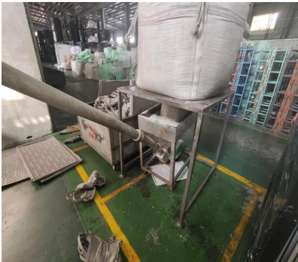
投料粉尘收集管道
