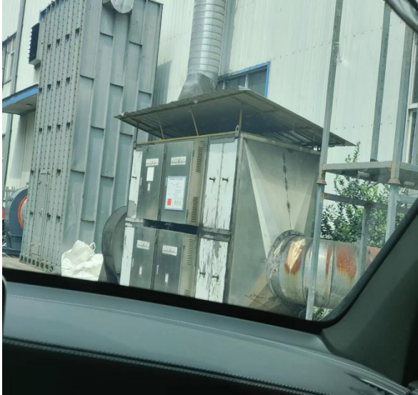
废气处理装置（两级活性炭吸附装置）
